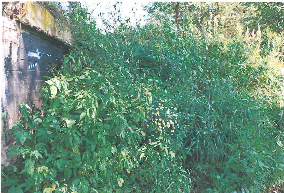
Fot. 5. Wegetacja roślin oraz zanieczyszczenia stożka spowodowane brakiem systematycznych prac utrzymaniowych - stożek od strony północnej i górnej wody.
