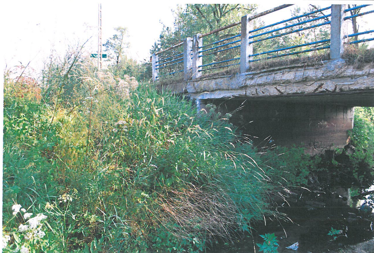
Fot. 20. Zanieczyszczenie przestrzeni podmostowej – widok na przyczółek od strony północnej.
