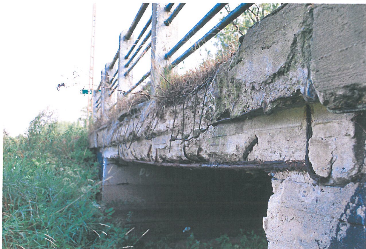
Fot. 13. Zniszczenie struktury betonu oraz stali zbrojeniowej gzymsu – widok od strony dolnej wody.
