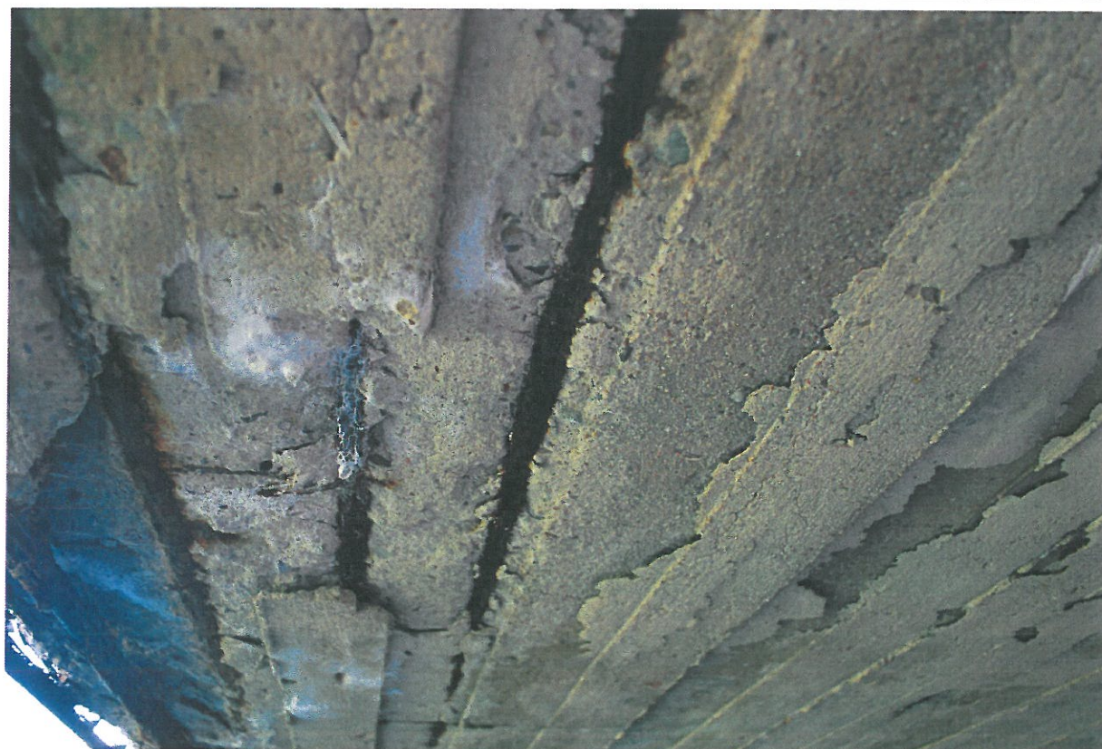
Fot. 16. Ubytki betonu, korozja betonu, korozja odsłoniętych prętów zbrojeniowych oraz zacieki i wykwyty świadczące o braku skuteczności izolacji płyty pomostu.
