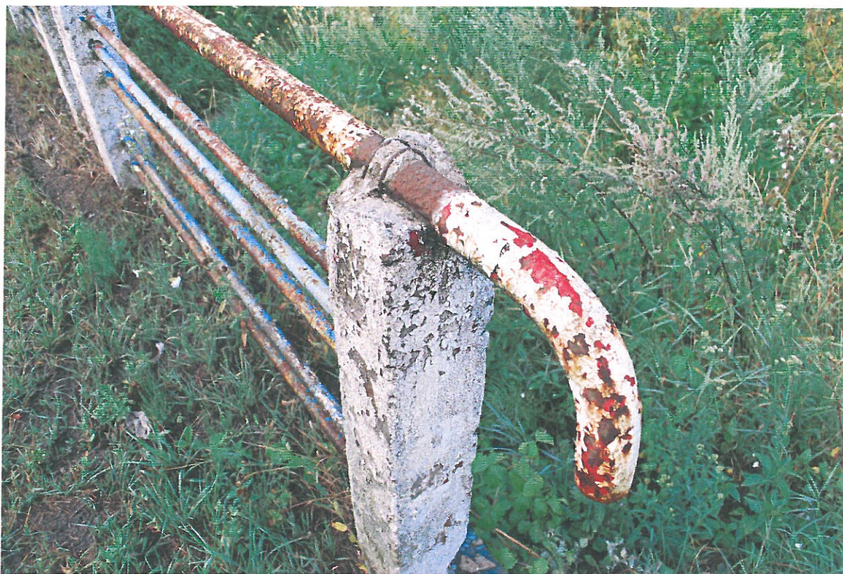
Fot. 11. Korozja zbrojenia oraz ubytki betonu słupka balustrady.
