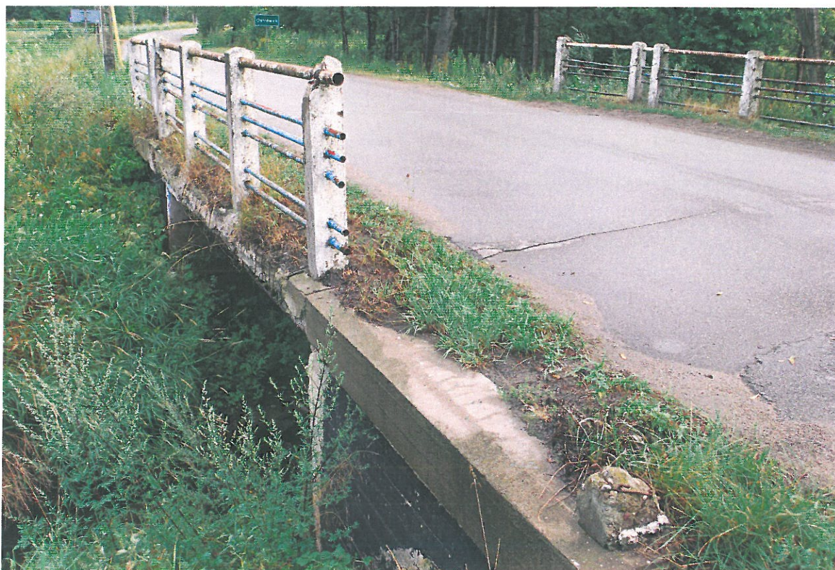
Fot. 9. Ubytki balustrady – widok od strony dolnej wody.
