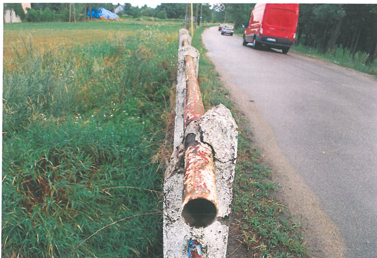
Fot. 10. Korozja pochwytu oraz ubytki betonu słupka balustrady.
