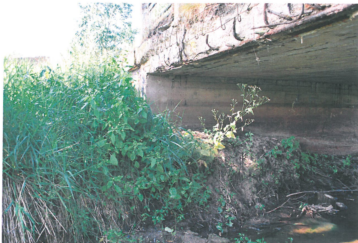
Fot. 19. Zanieczyszczenie przestrzeni podmostowej – widok na przyczółek od strony południowej.
