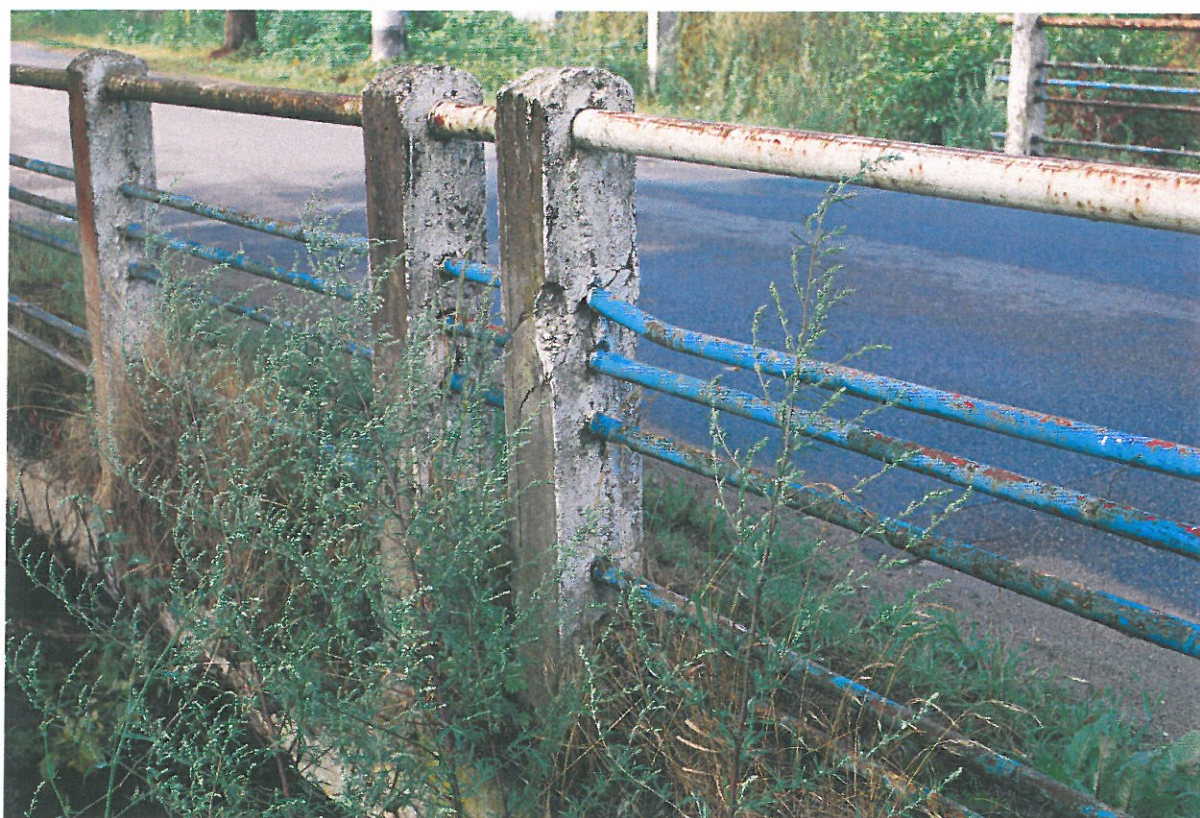
Fot. 12. Korozja i deformacja przeciągu oraz ubytki i pęknięcia betonu słupka balustrady.
