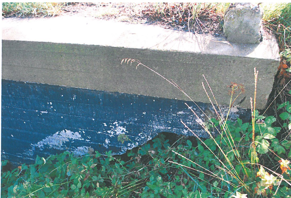
Fot. 6. Wegetacja roślin, ubytki i przemieszczenia gruntu (stożek od strony południowej – widok od strony dolnej wody)
