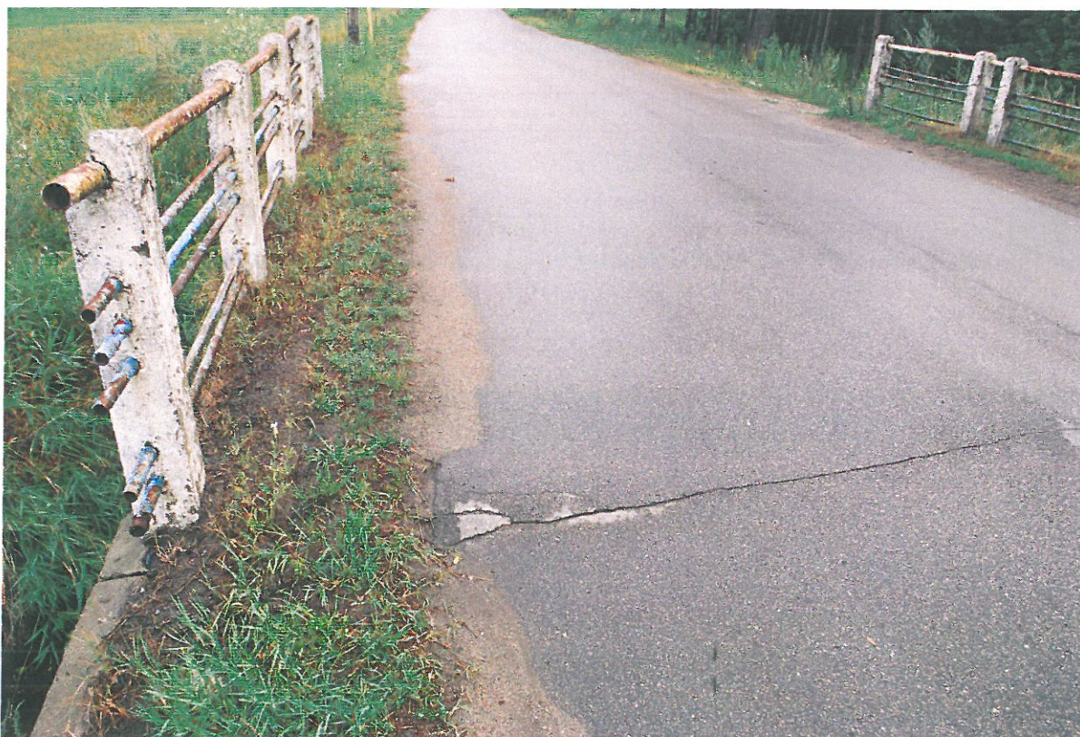
Fot. 8. Zanieczyszczenia, wegetacja roślin, rysy, ubytki, deformacje nawierzchni jezdni.
