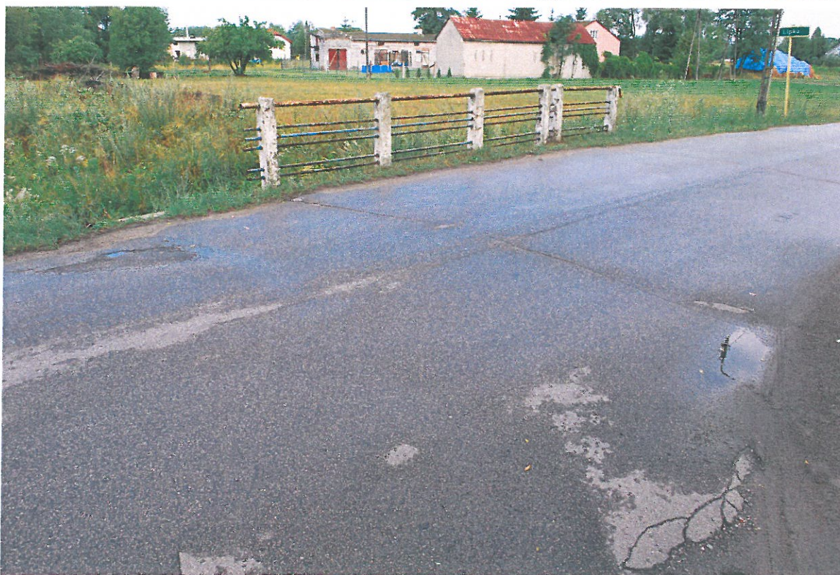
Fot. 7. Rysy, ubytki, deformacje nawierzchni jezdni na dojeździe od strony południowej.
