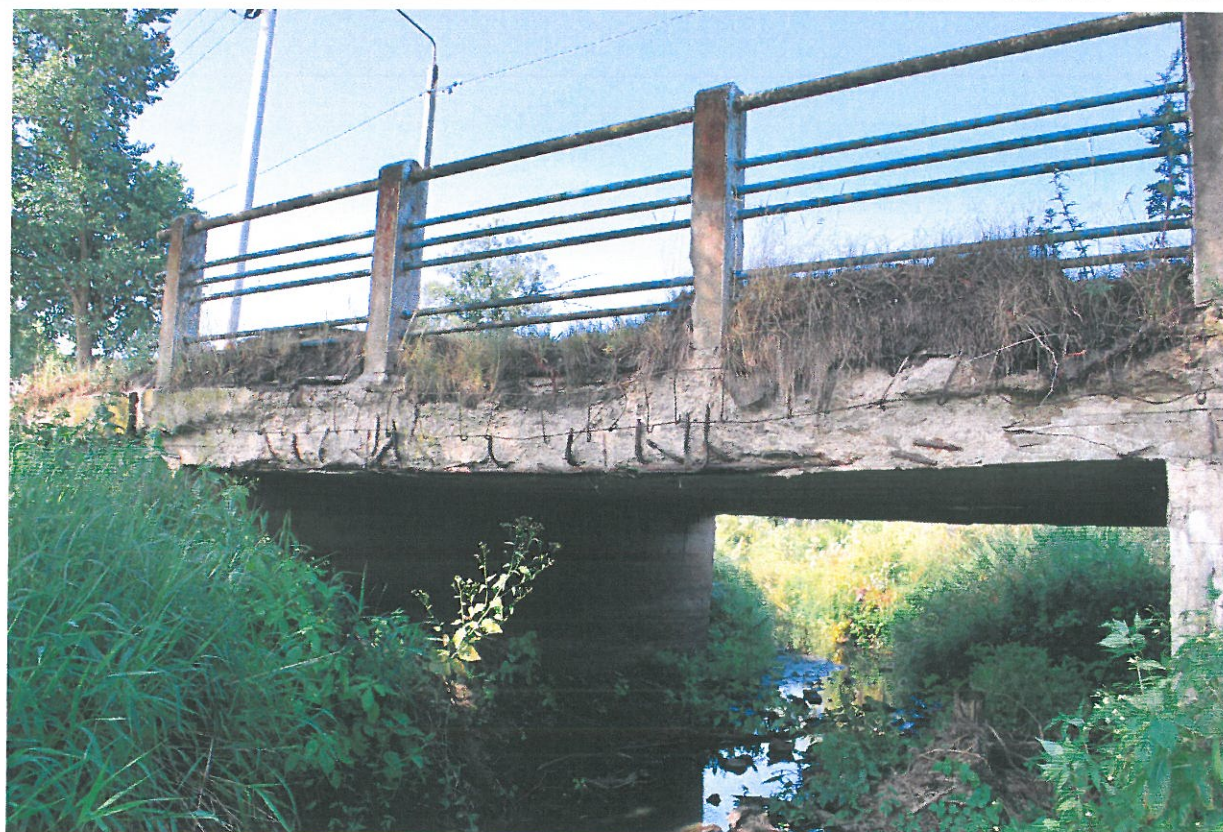
Fot. 14. Zniszczenie struktury betonu oraz stali zbrojeniowej gzymsu – widok od strony górnej wody.
