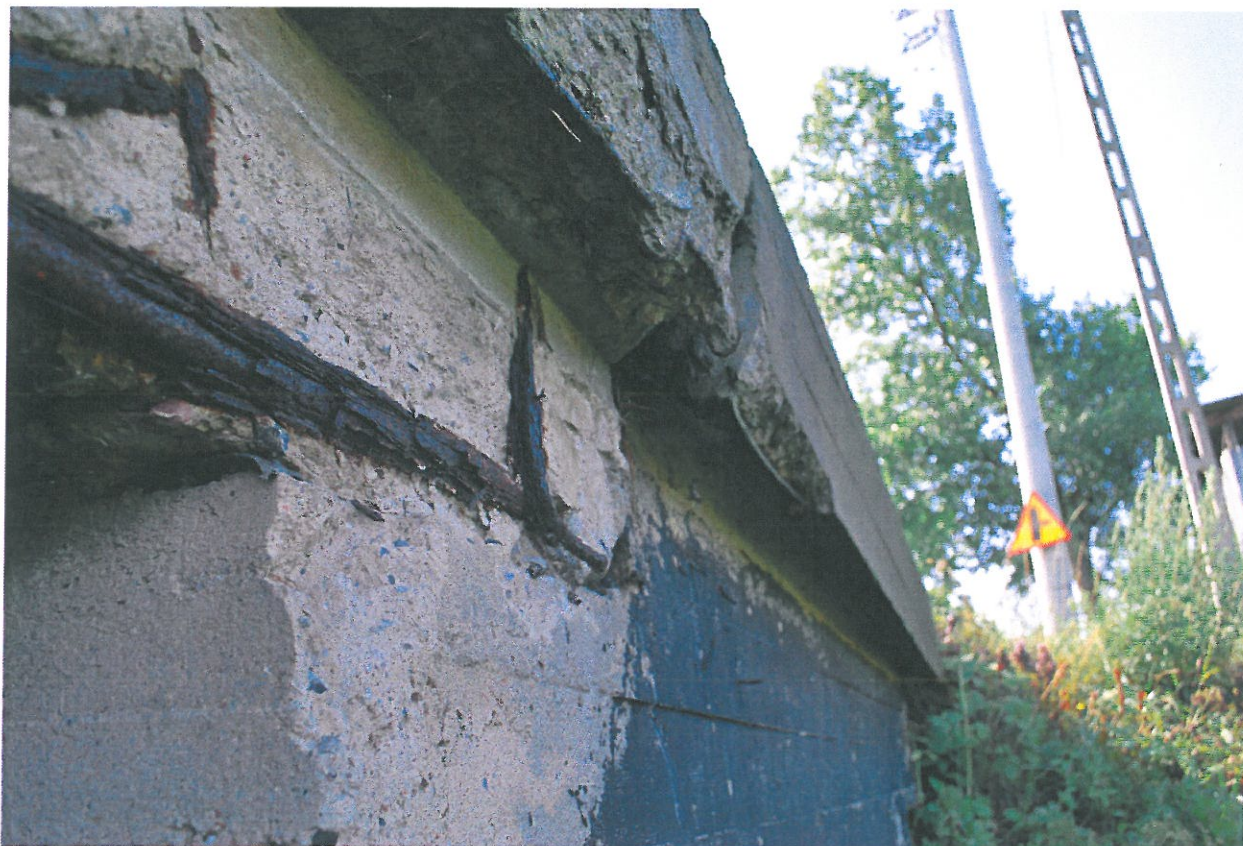
Fot. 17. Ubytki betonu, korozja betonu, zniszczenie struktury materiału prętów zbrojeniowych płyty pomostu.
